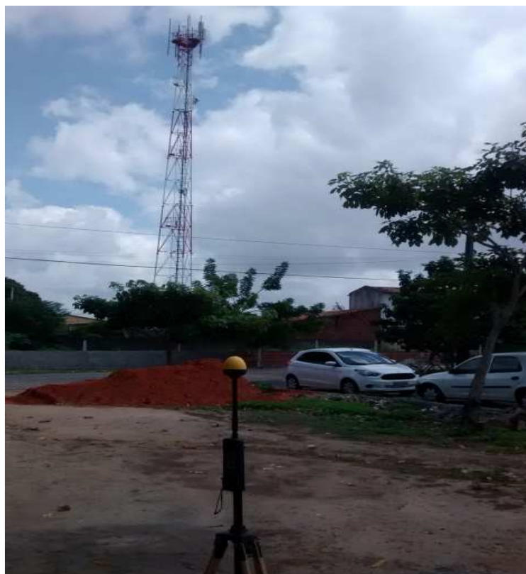
Figura 25 - Torre de ERB autoportante. Fonte: Autor
