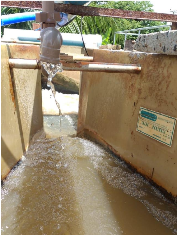
(b) aplicação do PAC na Calha Parshall
