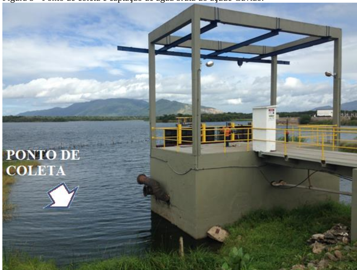
Figura 5 - Ponto de coleta e captação de água bruta do açude Gavião.
