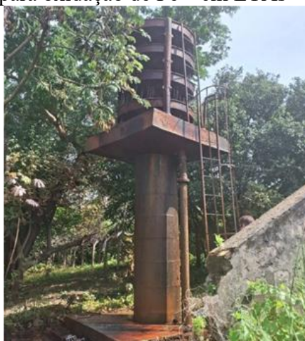
Figura 2 — Sistema aerador usado para oxidação de \text{Fe}^{2+} em ETAs
