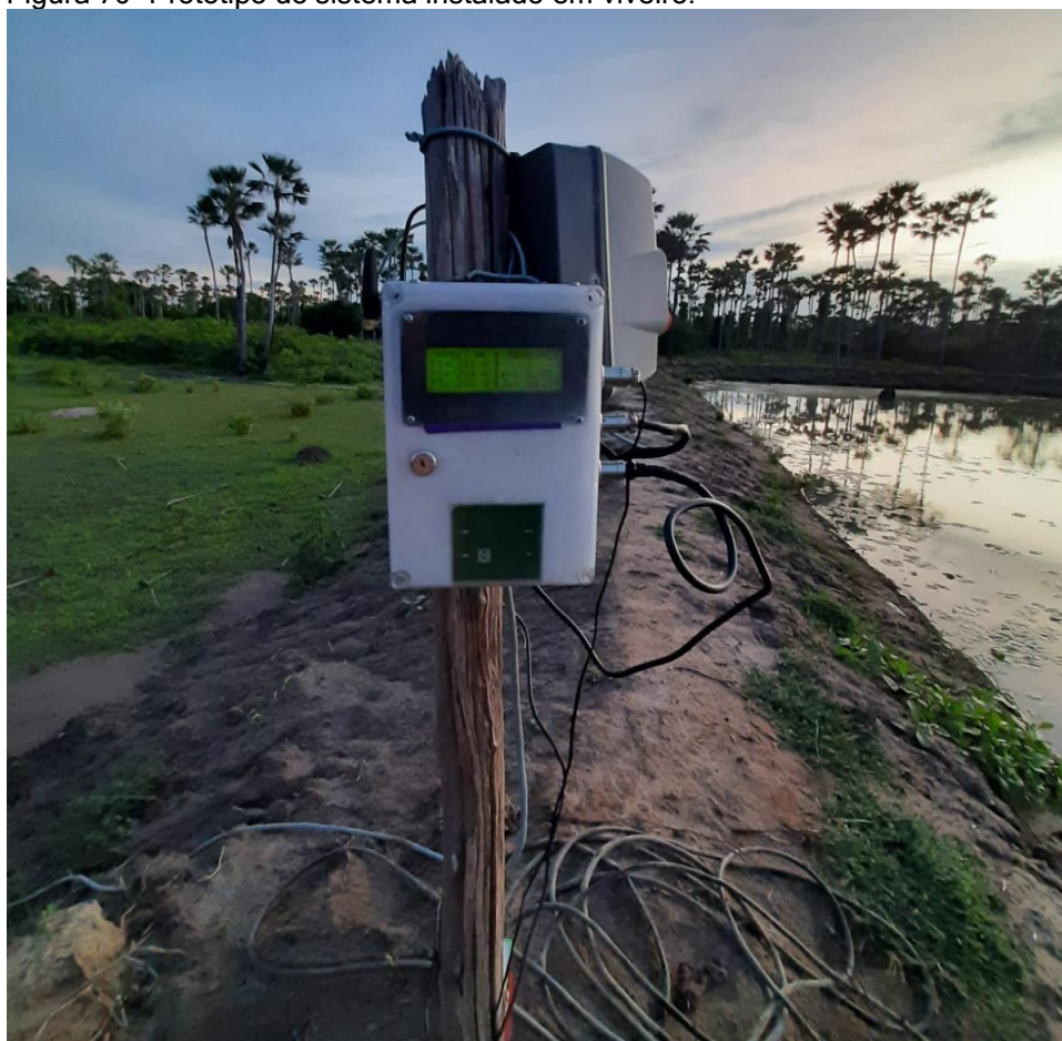
Figura 70- Protótipo do sistema instalado em viveiro.
